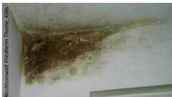
Exemple de moisissures liées à un pont thermique.
