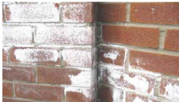
Exemple d'efflorescences de sels.
