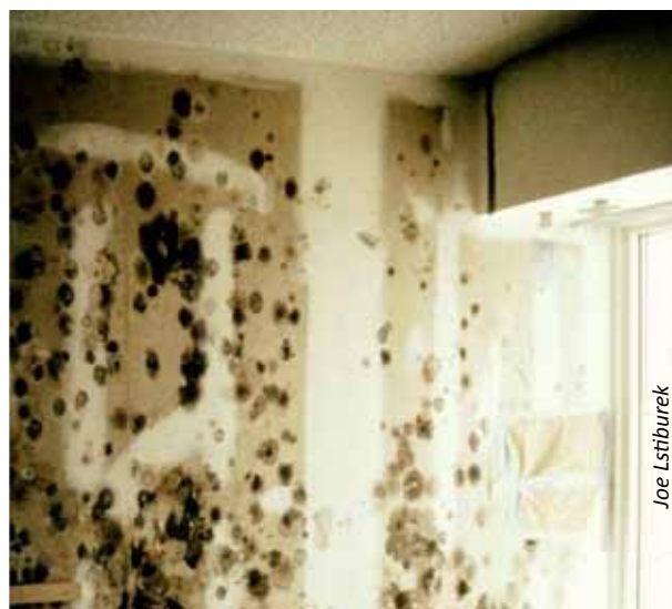
Exemple de moisissures dues à la condensation.
