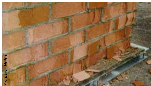
Exemple de briques gélives soumises au gel.
